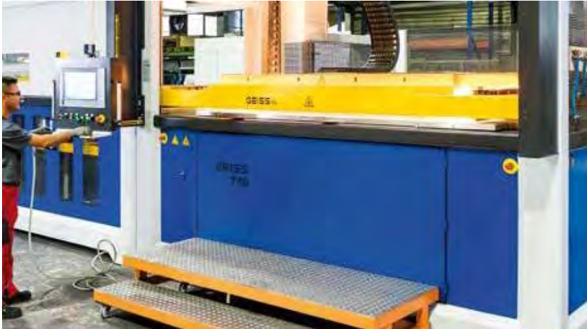
Neue energiesparende Tiefziehanlage
